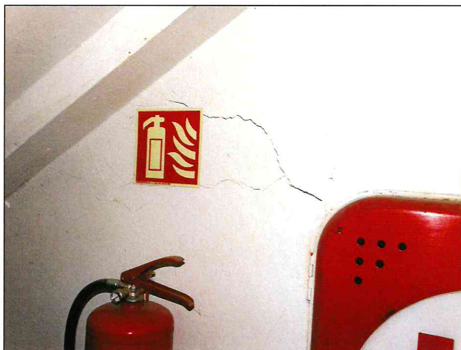
Nejedlého 2 – Trhlina u hydrantu v 1.PP – 12.4.2022 – Beze změny
