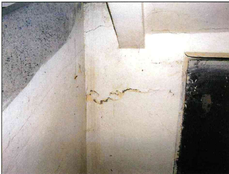
Nejedlého 2 – Trhlina pod schodištěm v 1.PP – 12.12.2019
