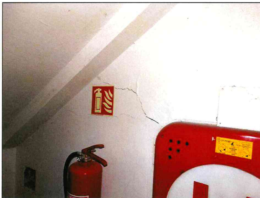
Nejedlého 2 – Trhlina u hydrantu v 1.PP – 12.12.2019
