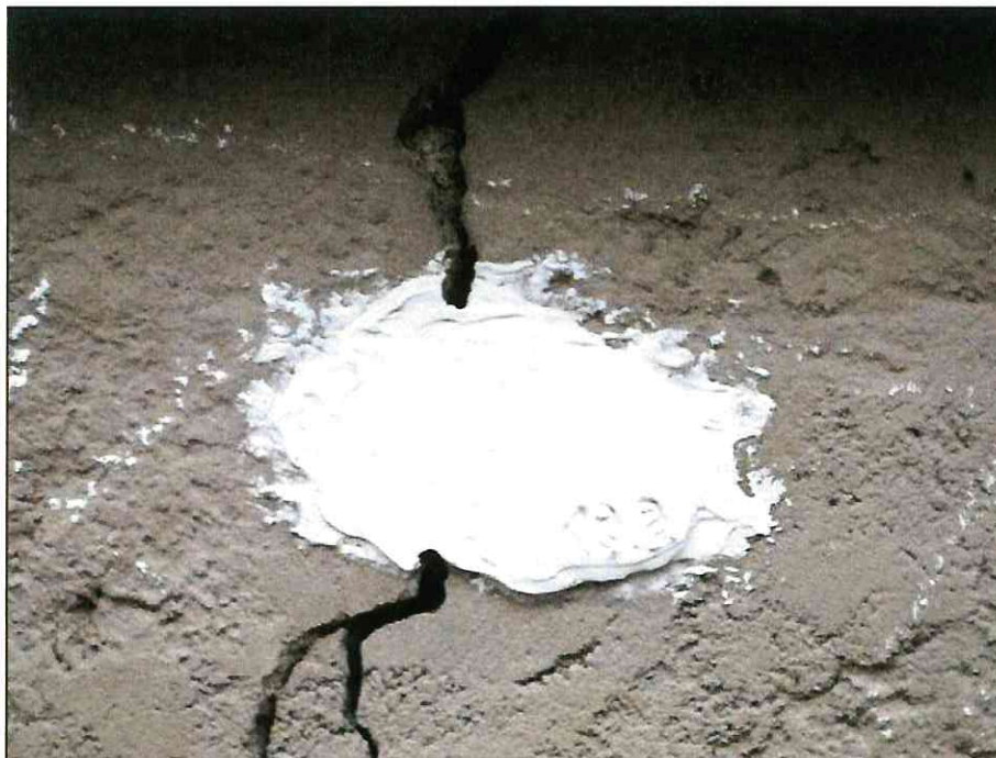
Horní terč pod oknem u jihozápadního nároží – 12.12.2019
