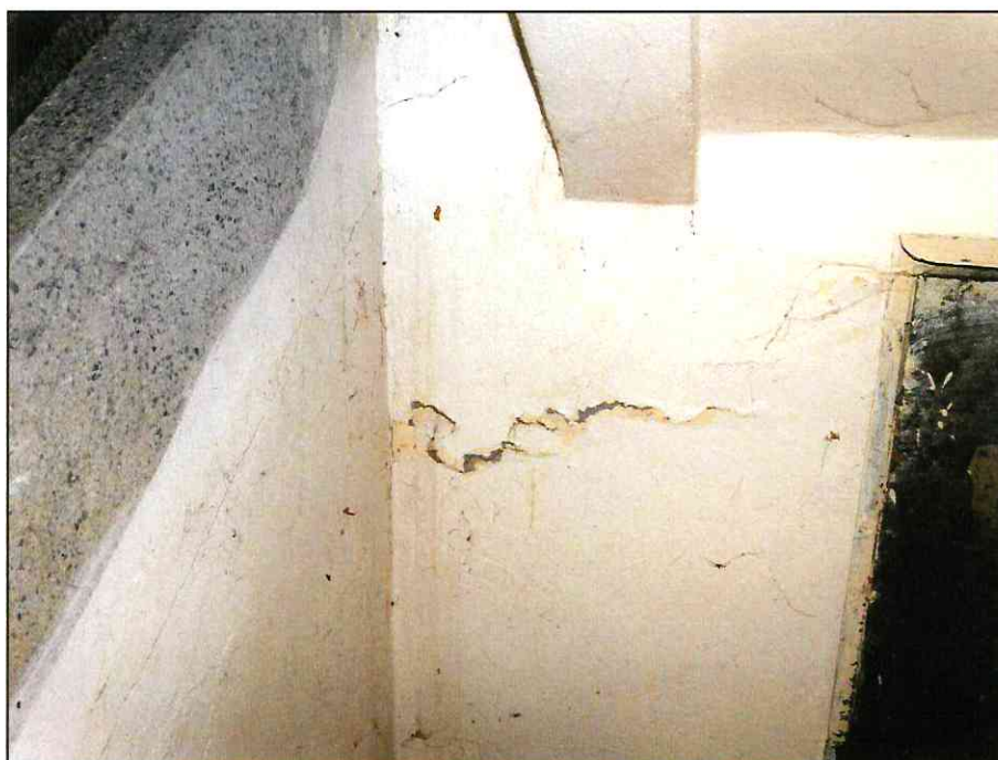
Nejedlého 2 – Trhlina pod schodištěm v 1.PP – 12.4.2022 – Beze změny
