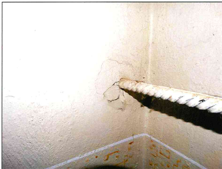
Nejedlého 2 - Průchod spínacího táhla stěnou na schodišti – 12.12.2019
